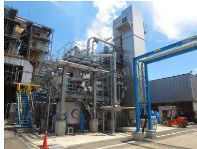
パイロットプラント 三友グループ川崎地区に設置 (水蒸気爆砕・酵素糖化・発酵施設)
