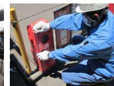
消火設備の確認
